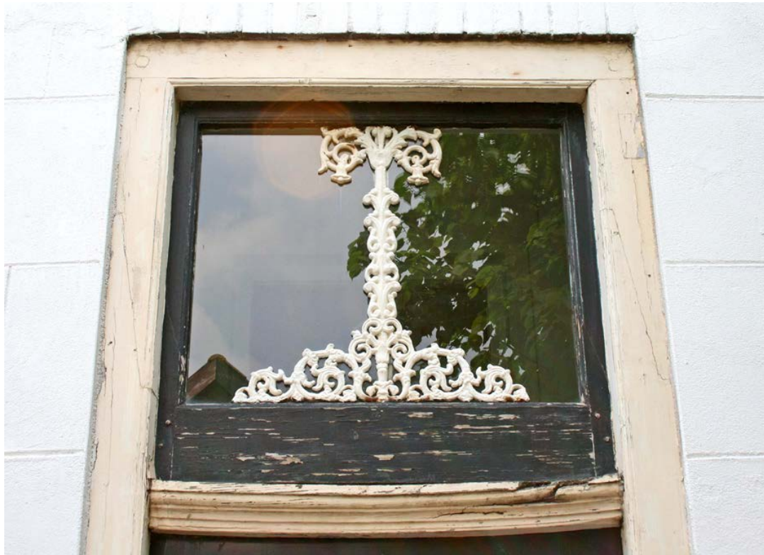
Opnemen van wandopeningen – inzicht in de constructie is bepalend voor het bepalen van de conditiescore op basis van aard, omvang en ernst van het gebrek.
