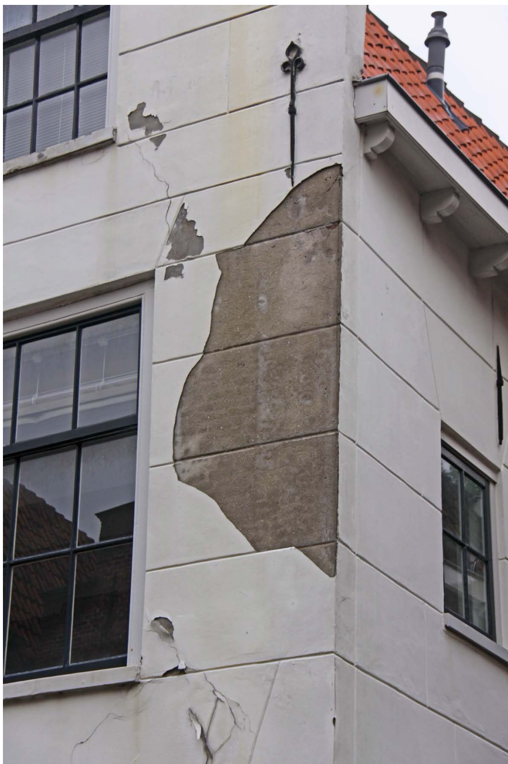
Wegvallende plakken pleisterwerk – bepalen van de oorzaak van het gebrek.
