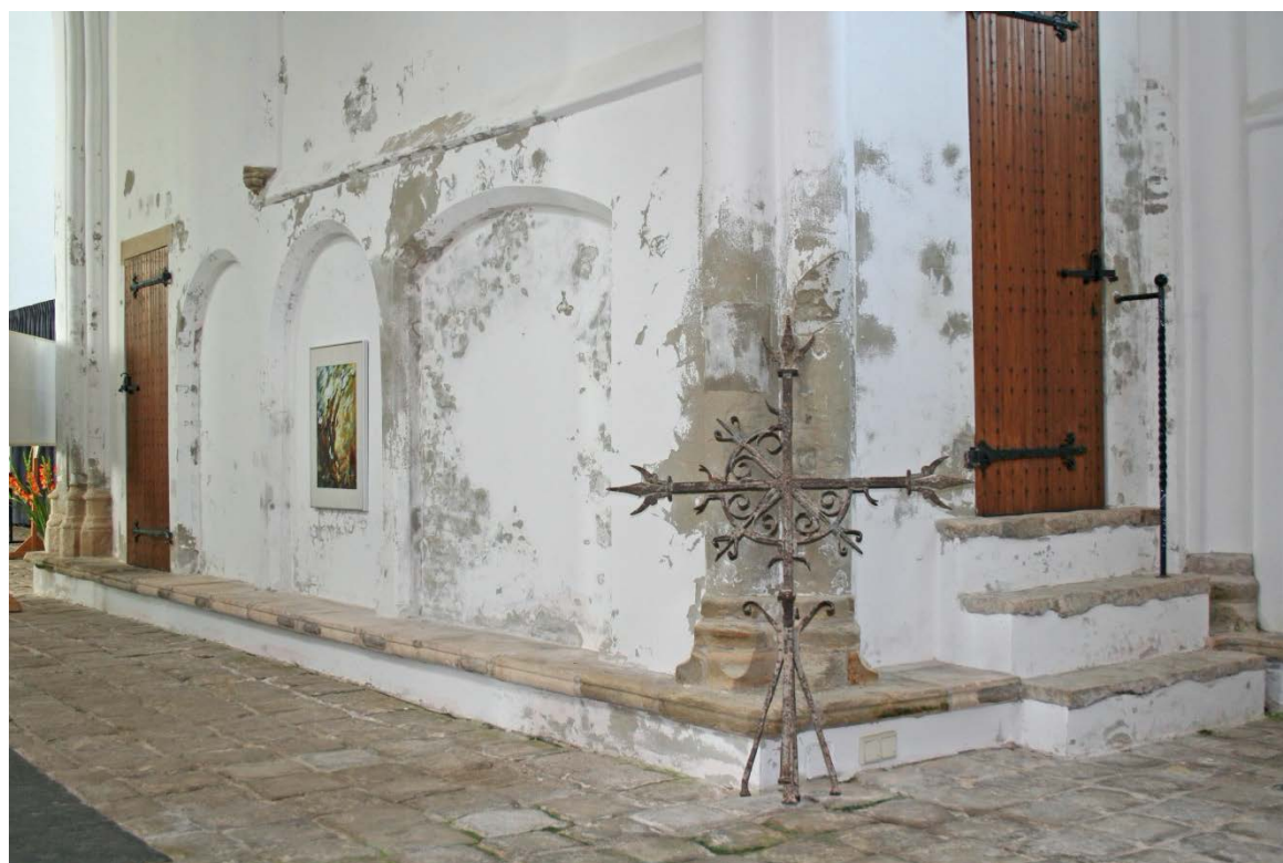
Aangetast pleisterwerk dat alleen begrepen kan worden als men weet dat in de kerk 2,5 m zout water heeft gestaan tijdens de Watersnoodramp in 1953.
